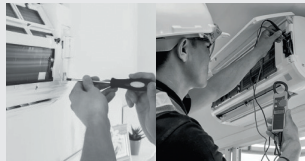
Difícil conexión eléctrica
