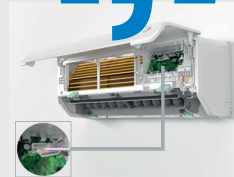
Abrir el cuadro eléctrico y desconectar los motores del ventilador, de las lamas y del ionizador
